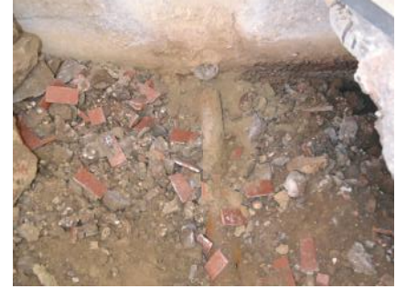
Indagini nel sottosuolo: tubazione rotta
